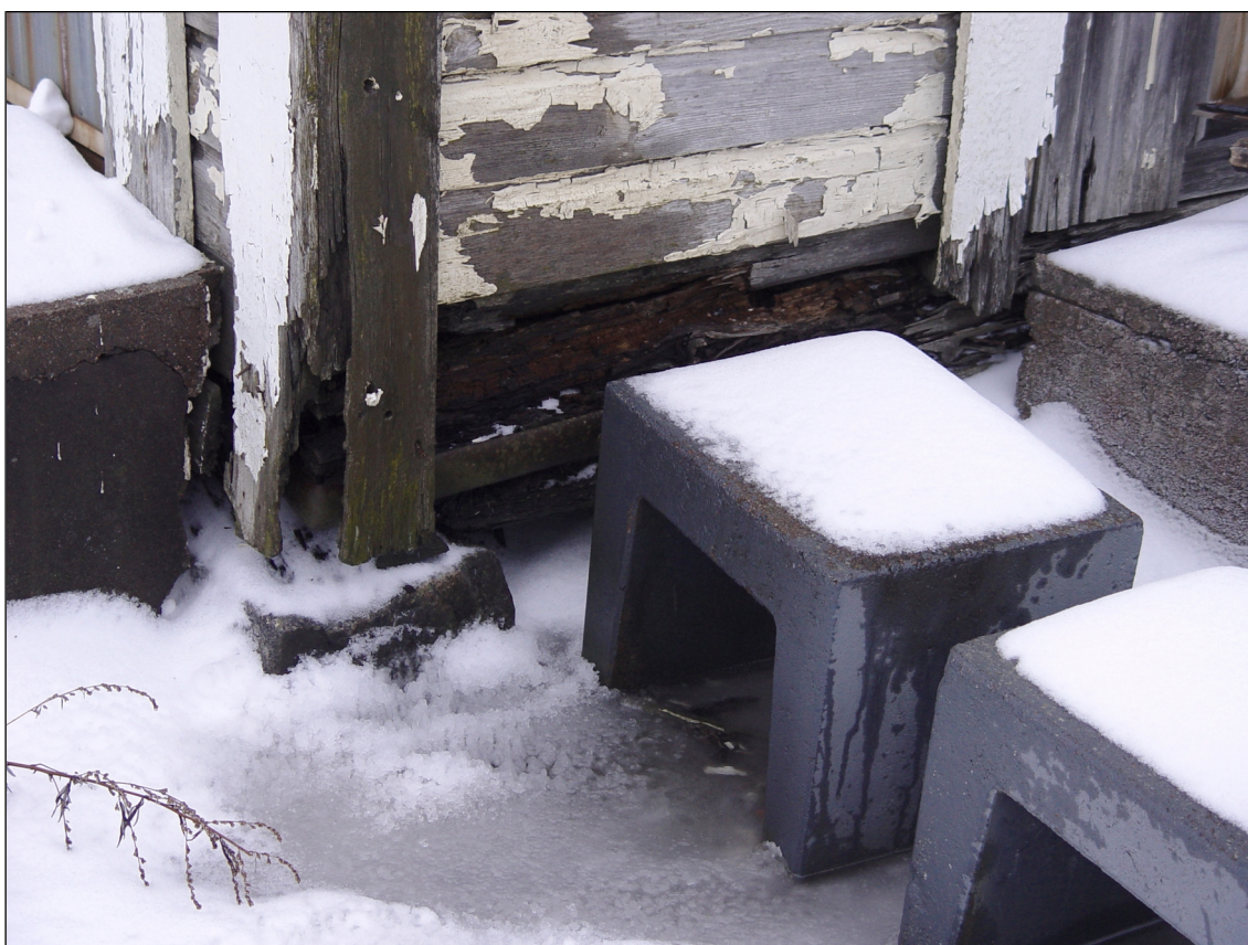
Kuva 7 Alahirsien lahovaurioita on laajalti nähtävissä esimerkiksi rakennuksen itäpäädyssä.
