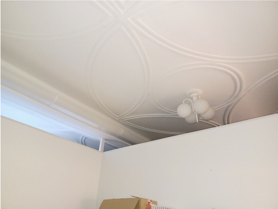
Kuva 47 Katon koristemuodot ovat edelleen jäljellä, mutta itse valtuustosali on jaettu useaan pienempään tilaan. Kattokuviot ovat todennäköisesti olleet moniväriset. Valaisimet eivät ole alkuperäiset.
